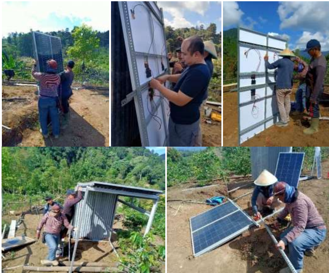
Gambar V.2 Instalasi PLTS Komunal
