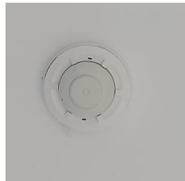
Gambar 4. 7 Heat Detector Gedung Mahligai Sembilan.
