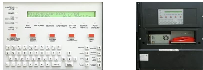
Gambar 4.5 Master Control Fire Alarm Gedung Mahligai Sembilan
