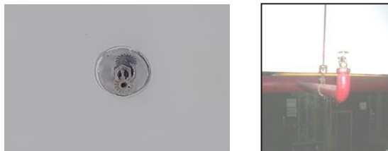
Gambar 4.8 Sprinkler Gedung Mahligai Sembilan
