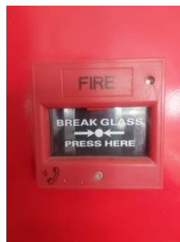
Gambar 4.4 Alarm Kebakaran Gedung Mahligai Sembilan
