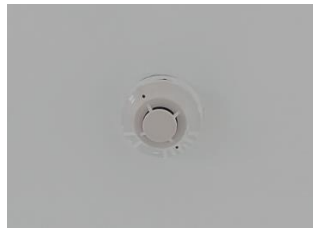
Gambar 4.6 Smoke Detector Gedung Mahligai Sembilan
