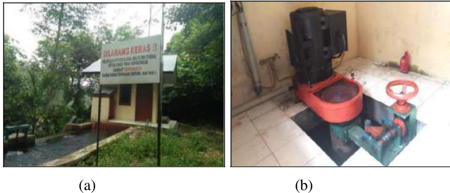
Gambar 5.4 Pembangkit Listrik Tenaga Mikro Hidro, (a) Lokasi (b) komponen
