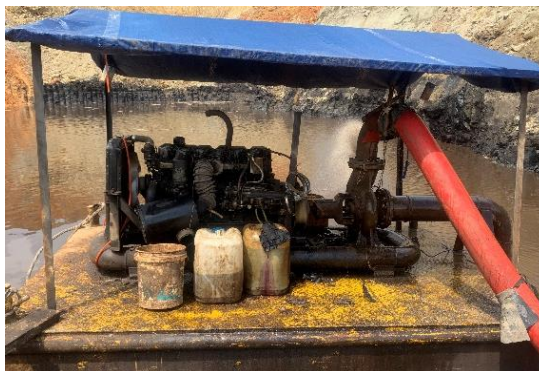
Gambar 49. Pompa PT. BMS (Sumber Penulis, 2023)
