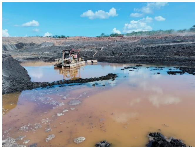
Gambar 7. Kondisi aktual Pompa Pada Area Front Coal Getting
