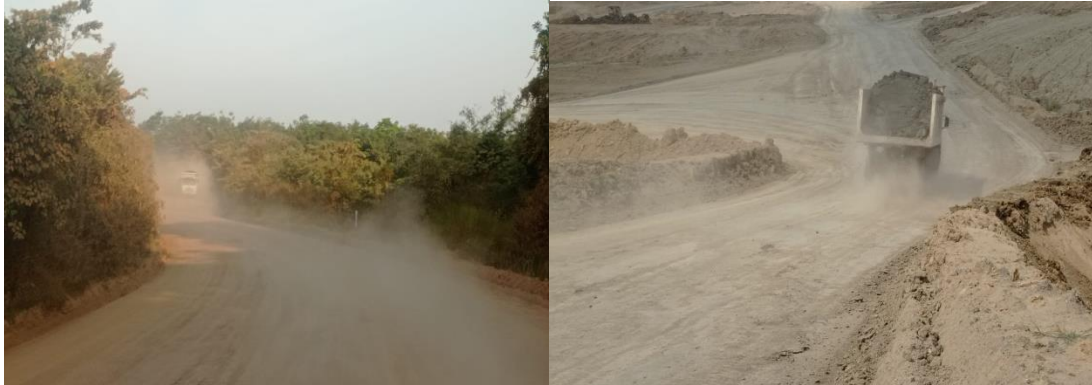
Gambar 15 Kondisi Jalan Tambang Berdebu
