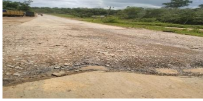
Gambar 3.2 kondisi jalan (Sumber :Hasil Survey, 2022)
