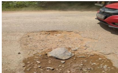
Gambar 3.4 Kondisi Jalan (Sumber :Hasil survey, 2022)
