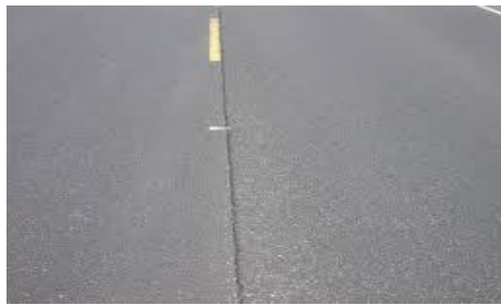
Gambar 2.5 Retak Sambungan Jalan
