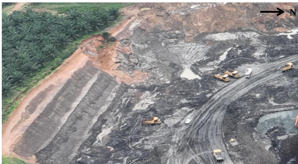
Gambar 31. Kondisi Lereng Side Wall Selatan
