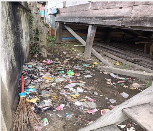
Tumpukan sampah di bawah bangunan sekolah menuju kelas
