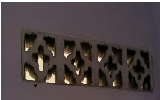
Gambar 5 Tidak terdapat kawat kasa pada ventilasi di rumah responden
